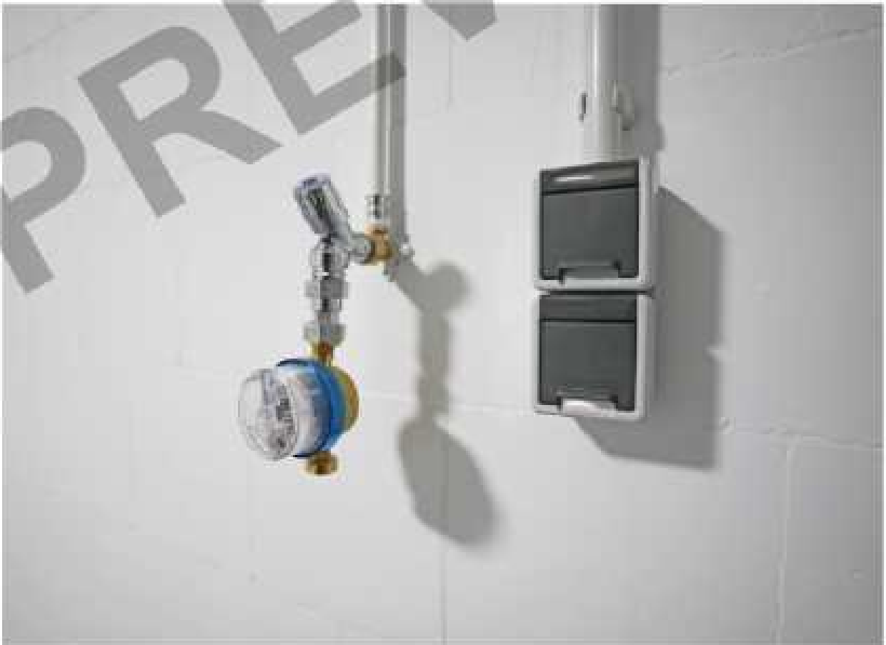
Wasseruhr und Steckdosen für Waschmaschine und Trockner - UG
