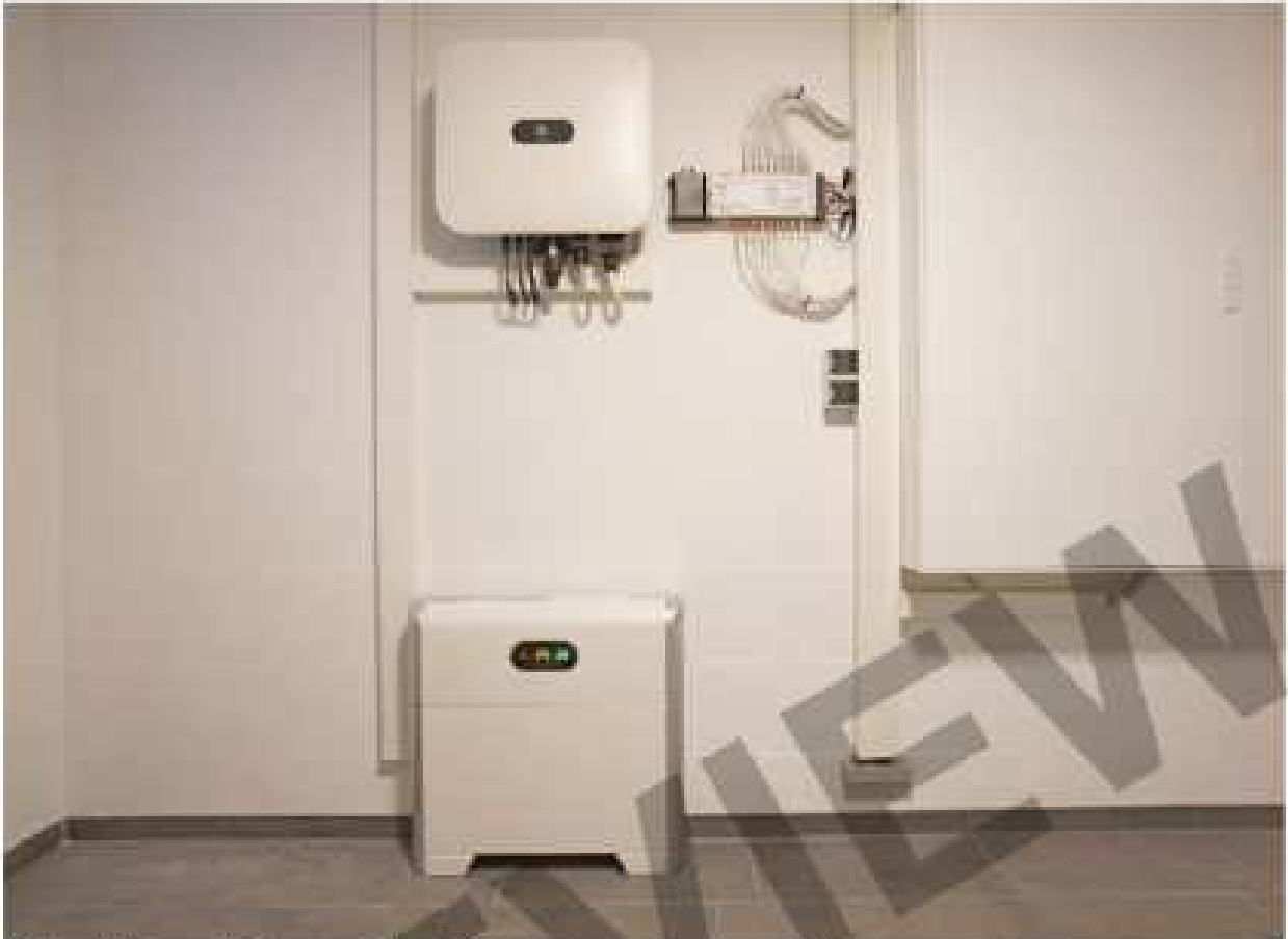
Wechselrichter und Batteriespeicher - UG
