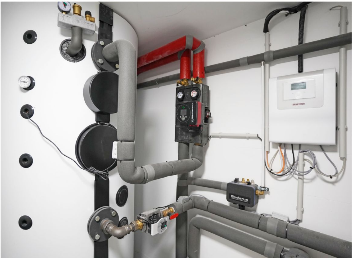
Heizungsanlage und Warmwasserspeicher - UG
