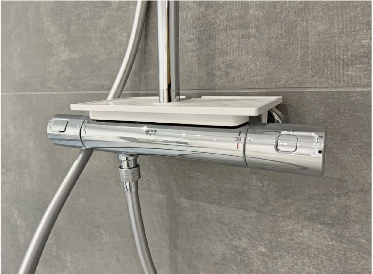
Mischarmatur - Wohnung 1 - EG links
