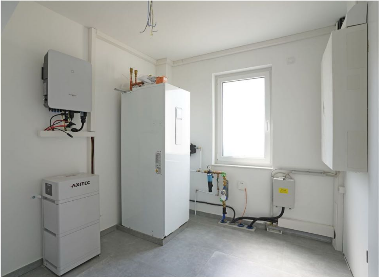
Hausanschluss- und Hauswirtschaftsraum
